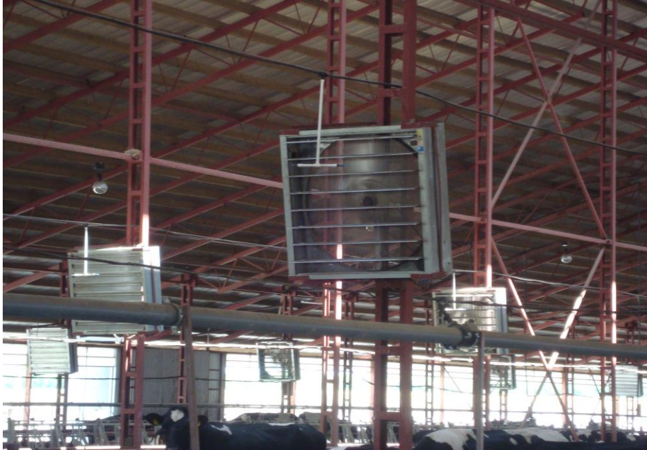
Рис. 2. Вентилятори і пристрої водного зрошення
