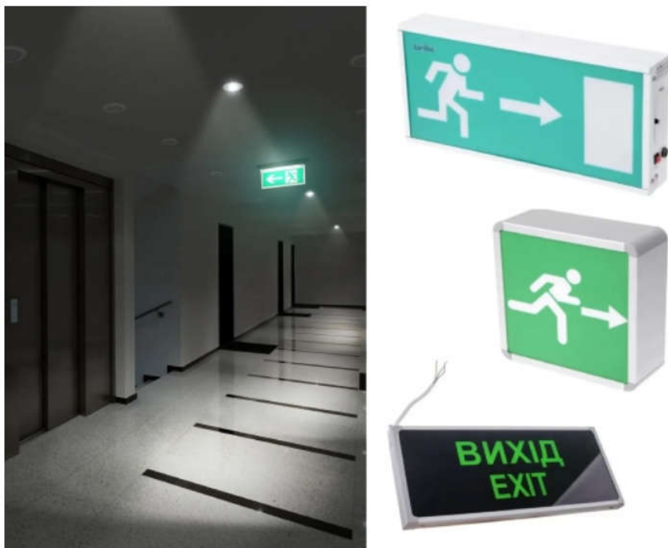
Рис. 6.1 – Приклад аварійних світильників
