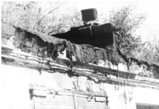
Фото 4. Руйнування карниза і покриття зерносховища
