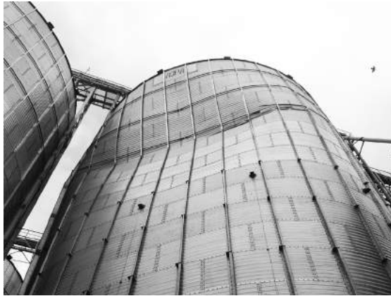
Фото 2. Втрата загальної стійкості ребер жорсткості та деформативність оболонки сталевих силосу
