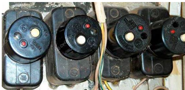
Рисунок № 3. Зовнішній вигляд пробок в старому приватному будинку
