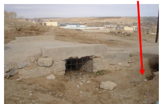
Мости, водостічні проходи.
