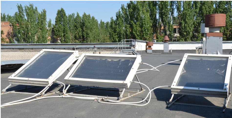
Рис. 7.2 – Лабораторні плоскі сонячні колектори кафедри електротехнологій і електропостачання МНАУ
