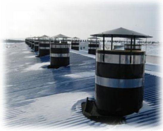
Рис. 8. Витяжні канали тваринницького приміщення
