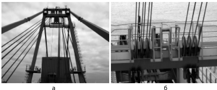
Рис.2. Зовнішній вид судоперевантажувача зі зміцненими обкатуванням канатними блоками, встановленими на пілоні (а) і виносній консолі мосту з боку моря (б)
